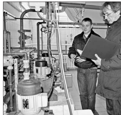
LWG-Gruppenleiter Bernd Scheppan (li.) erläuterte dem TÜV-Auditor Andreas Wahoff Anlagen im Wasserwerk Cottbus-Sachsen-dorf Foto: LWG
