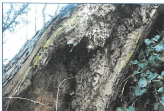
Abbildung 6.9: Detailansicht des Stammes mit Spuren holzbewohnende Käfer
